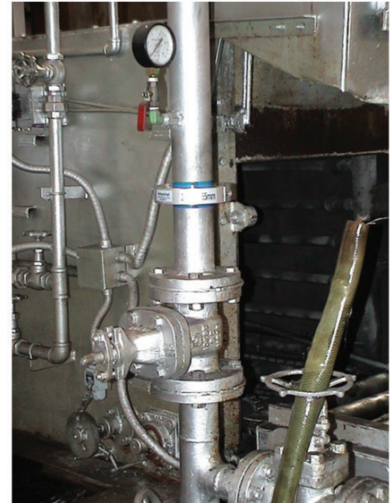
제품 설치 전경
