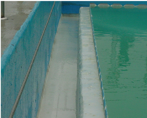
설치전 침전조 Weir (석고 형태의 피막으로 코팅이 됨)
