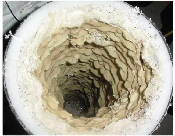
원수배관 내부상태 (배관설치 10개월후 상태)
