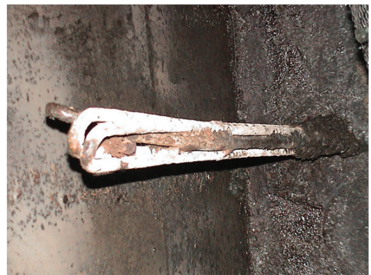
설치전 오일탱크내 히터주위
